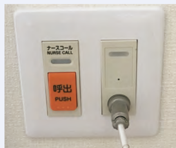
緊急通話・通報装置
